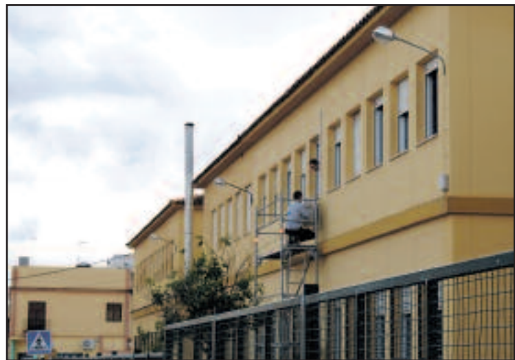
Alumnos de la Escuela Taller Mairena Innova instalando los equipos en el colegio Huerta Retiro
