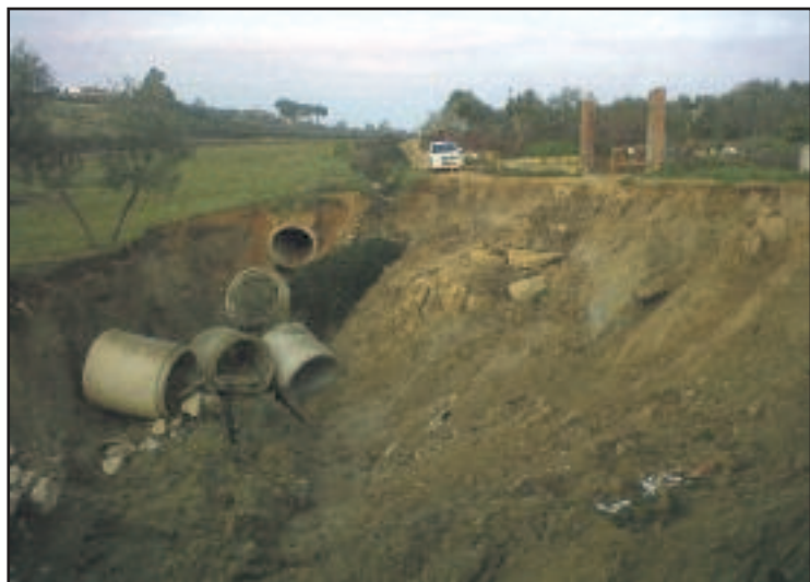
El aliviadero del colector del Carrascal en el camino de la Fuente de la Cañada será reparada en las próximas semanas
