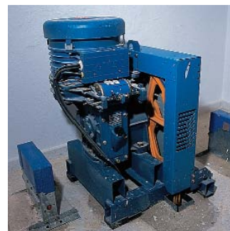
14. Maquinaria de ascensor.
