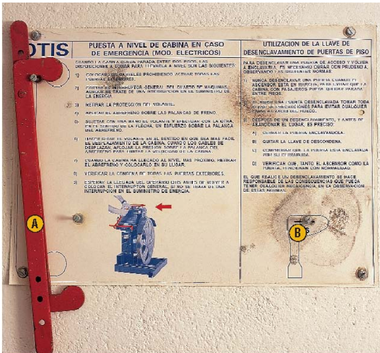
13. Instrucciones impresas en sala de máquinas, para rescate de personas en cabina. A. Dispositivo abre-frenos. B. Llave de desenganche de puertas de piso.
